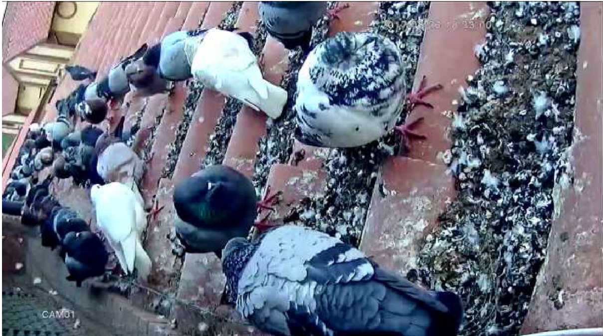
Figura 2. Tejado sur antes de la puesta del sol (18:33) el 26 de marzo de 2017, tres días antes de la instalación de Bird Free .
