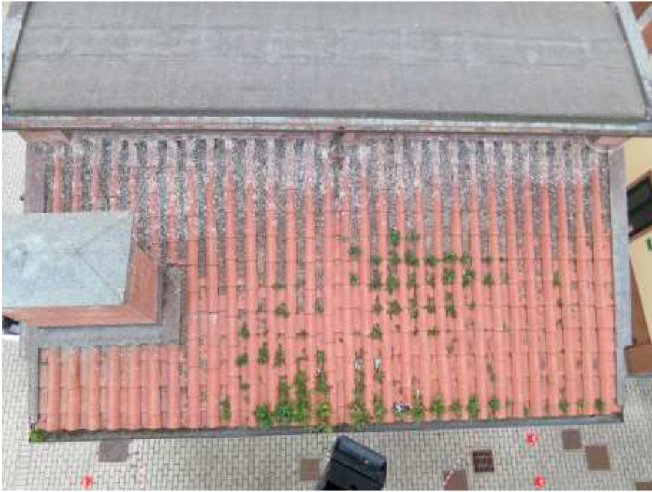
Figura 6. Tejado norte antes de la limpieza y tratamiento.
